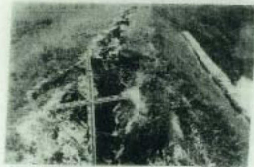
写真4-1-34 七北田川右岸堤防の被災
