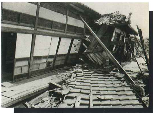
■ “支え”で崩壊を防ぐ古い農家(市内 六郷)
