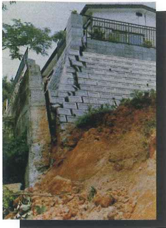
■ 市内緑ヶ丘団地の崖崩れ
