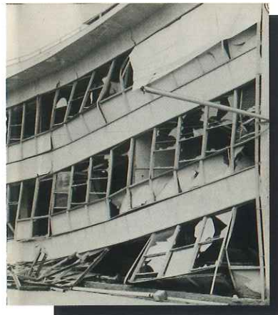
■ 1階が押し潰され、全体が弓なりに曲がったビル(市内 苦竹)
