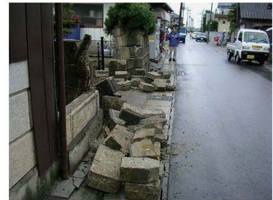
宮城県北部地震の石積み・ブロック塀の倒壊写真
