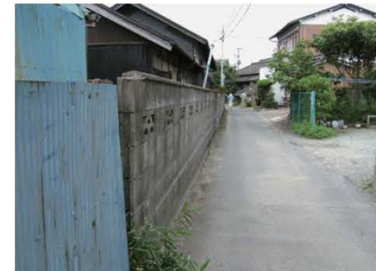
ブロック塀と避難路？地震の時は大丈夫？？
