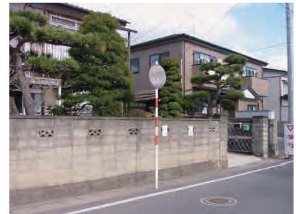
きれつの入ったブロック塀
