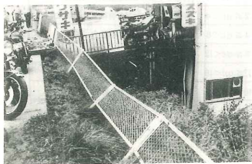
写真5・2・11 被災状況(仙台市福田町)
